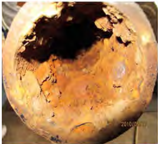
管道腐蚀严重： 腐蚀产物释放进入水中
