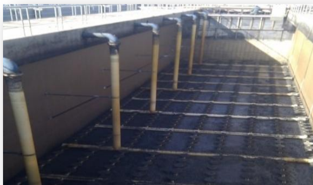
填料导出后的曝气池
